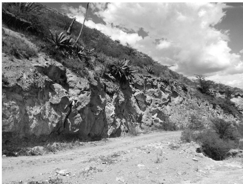
Рисунок 1. Подрезанная нижняя часть склона.
